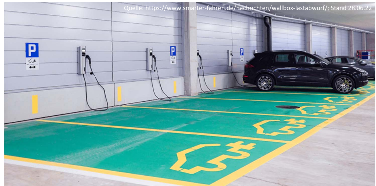
Tiefgaragen-Stellplätze mit Wallboxen (Ladestationen für E-Mobilität)
